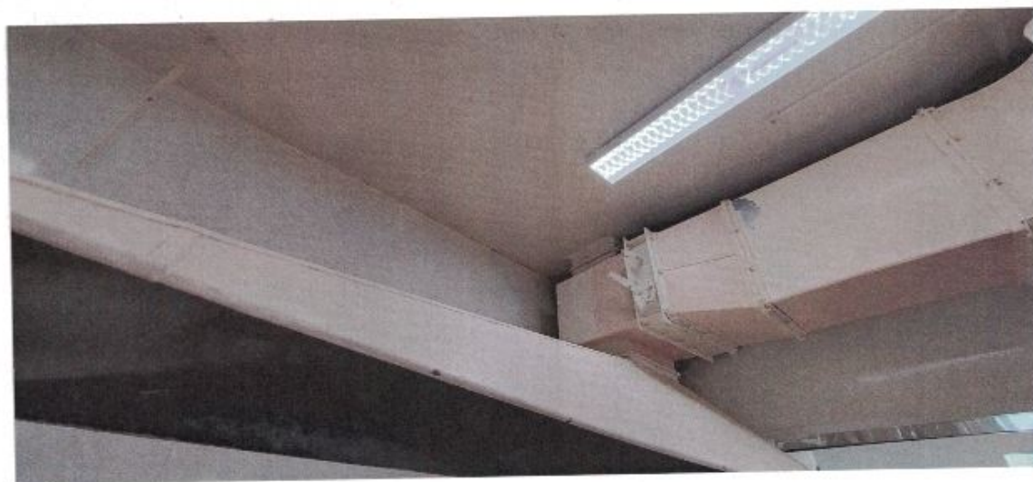
Фото 39 – Трещины и отслоение межплитных швов перекрытия
