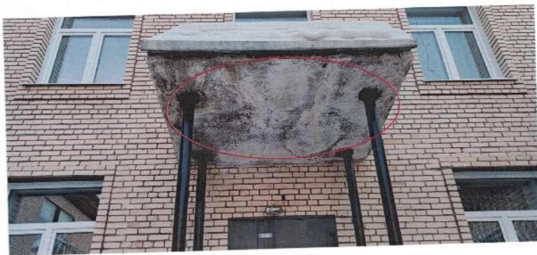
Фото 51 – Замачивание плиты покрытия крыльца
