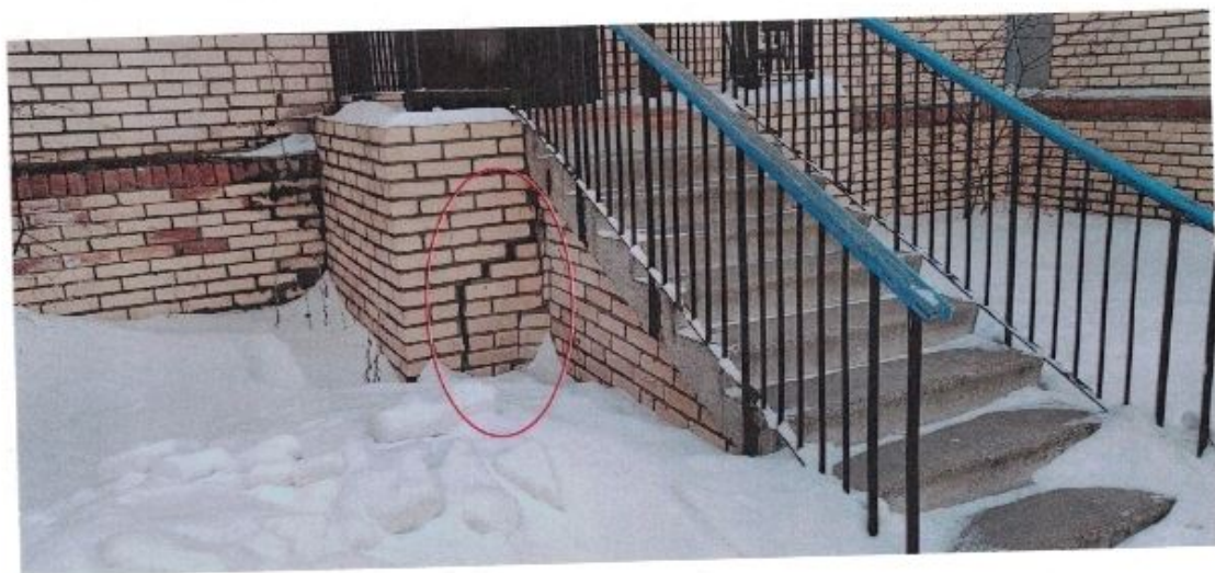
Фото 50 – Силовая трещина по кирпичной кладке крыльца
