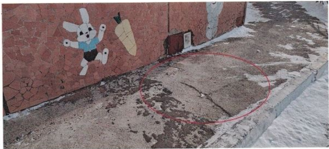
Фото 16 – Локальные трещины в отмостки
