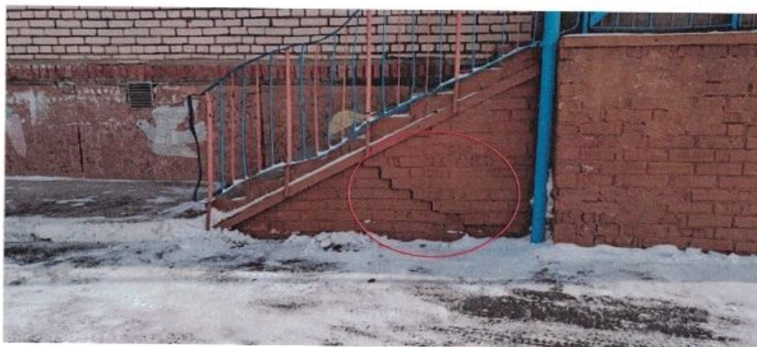
Фото 52 – Силовая трещина по кирпичной кладке крыльца
