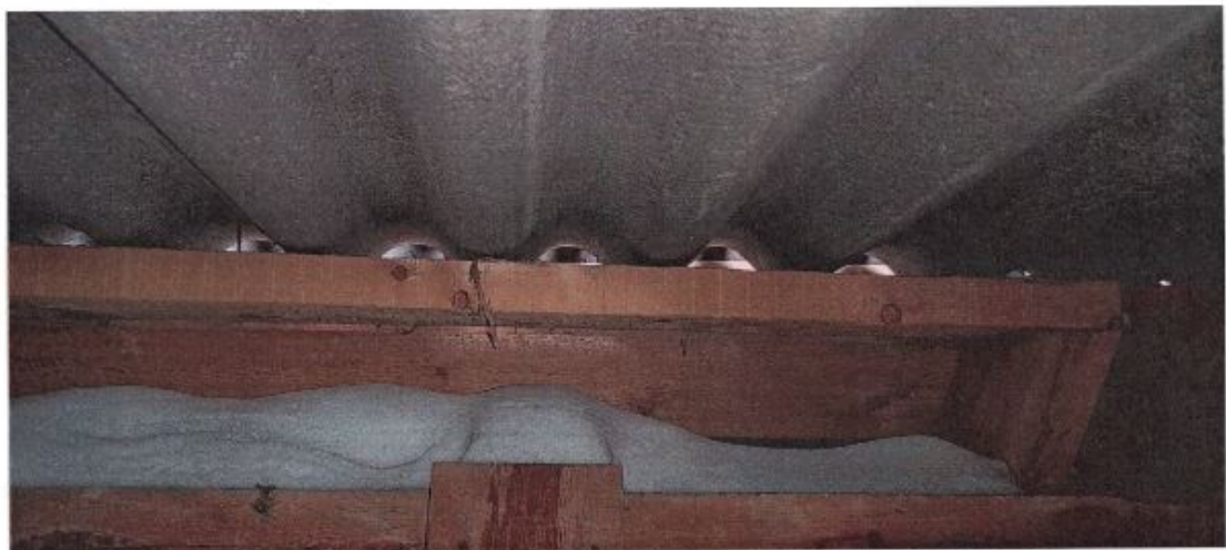
Фото 48 – Коньковая деревянная планка вследствие деформаций и гнилостного повреждения не выполняет свои функции
