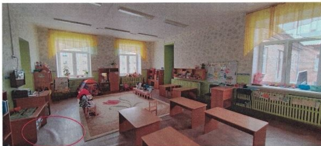
Фото 41 – Отслоение, волнистость линолеума
