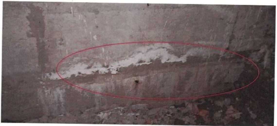
Фото 21 – Высолы в межблочных швах
