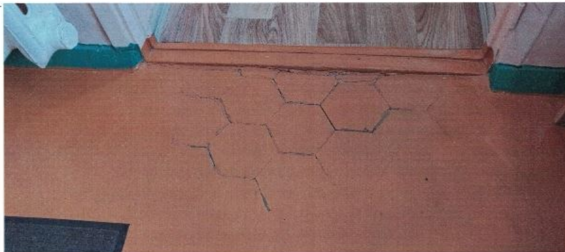
Фото 40 – Локальное отслоение плитки
