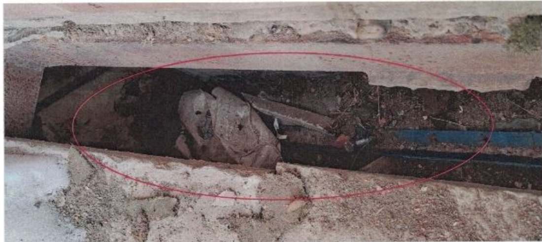
Фото 15 – Образование пустоты под отмосткой
